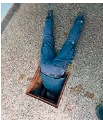
Dieser Schacht ist viel zu eng und widerspricht allen Normen.
