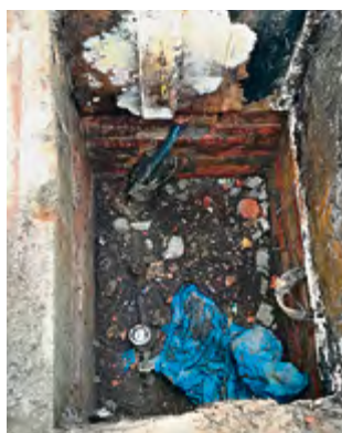
Derart verstreckt und zugemüllt darf kein Wasserzähler sein.
