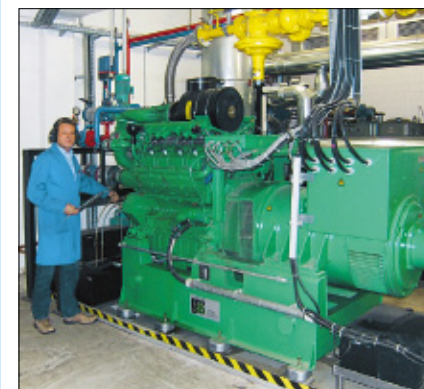
Im Kreislauf: Das hauseigene Blockheizkraftwerk (BHKW) verbrennt Faulgas und erzeugt dabei Strom und Wärme. Die gewonnene Energie fließt zurück in den Klärprozess. Das BHKW liegt in den Händen Günter Mertens, der die elektronischen Anlagen im Abwasserbereich der FWA koordiniert.
