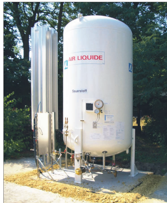
Die Reinsauerstoffdosieranlage für das Projekt.
