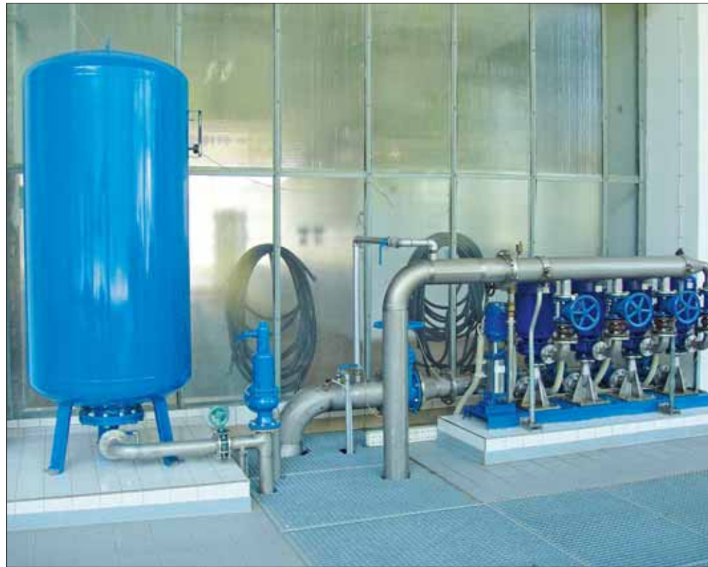
Membrandruckbehälter (links) und Pumpen der Druckerhöhungsanlage.
