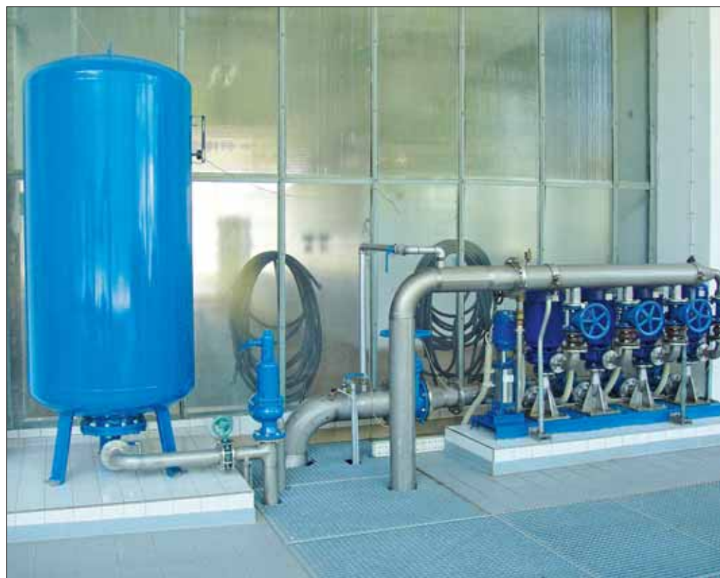
Membrandruckbehälter (links) und Pumpen der Druckerhöhungsanlage.
