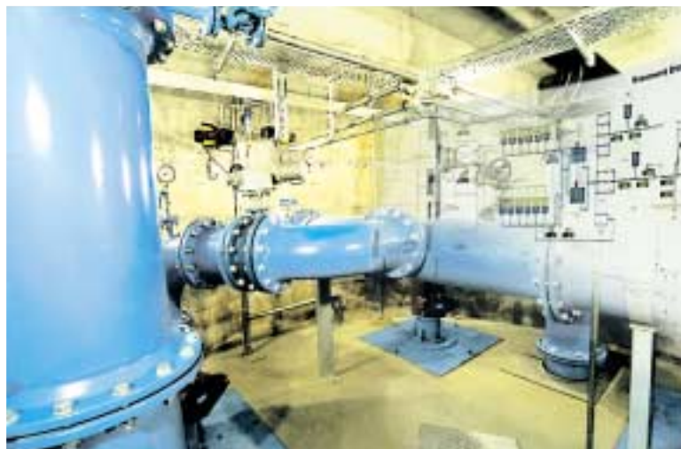
Die von Siemens installierte Prozessleittechnik.
