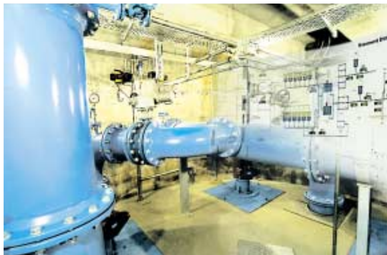
Die von Siemens installierte Prozessleittechnik.
