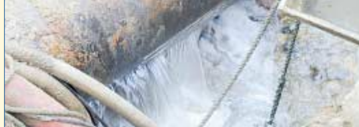
Aus einem 4 m langen Riss strömt das Wasser.
