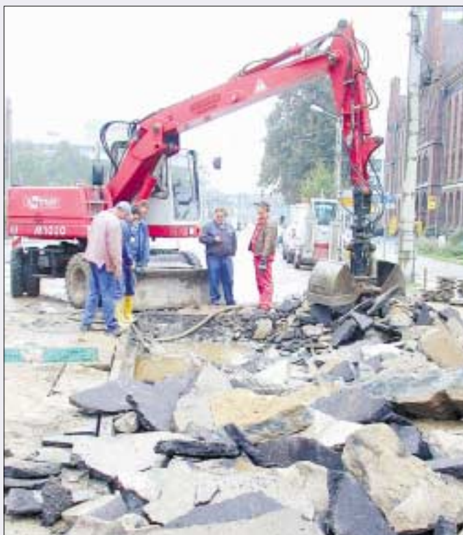
Rohrbrüche sind immer mit sehr aufwändigen Straßenbauarbeiten verbunden.
