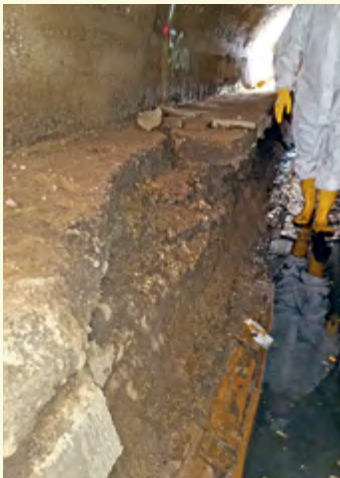
Nach der Hochdruckreinigung wurde das volle Ausmaß der Schäden sichtbar.
