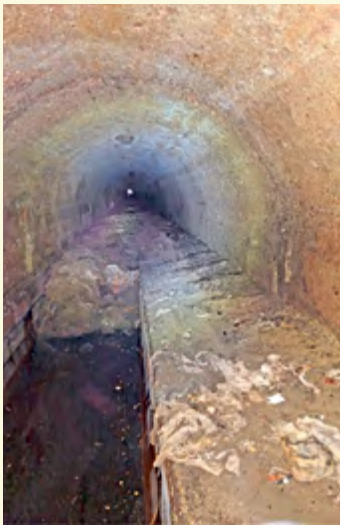
Der Zustand des 114 Jahre alten Kanals unmittelbar nach seiner Außerbetriebnahme.
