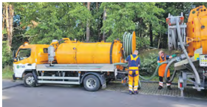
Dem kleinen 4-m 3 -Fahrzeug kommt manchmal ein ‚Großer‘ zu Hilfe, um das Abwasser umzupumpen.
