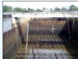
Im leeren Becken wird die energieversorgungsstarke Tellerbelüftung sichtbar.
