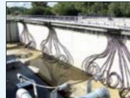
So sehen die Luftleitungen der neuen, energiesparenden Flächenbelüftung aus.
