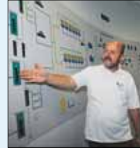
Burkhard Ahrens erklärt in der Leitwarte den Weg des Wassers.
