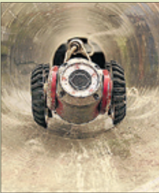
Etwa 30 Zentimeter lang ist die fahrbare Kamera, die sich durch die Rohre und Kanäle schlängelt.
