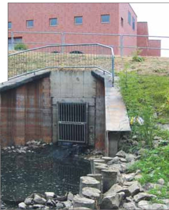
Das Plattenschieberbauwerk im Kanal Logenstraße.
