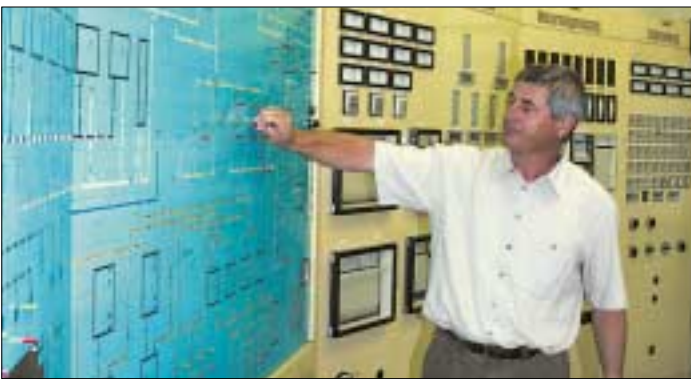
Reinhard Schmidt, Leiter Rohrnetz vor der neuen 20-kV-Anlage.
