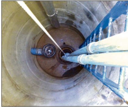
Diese Brunnenstube im Wasserwerk Briesen ist generalüberholt.
