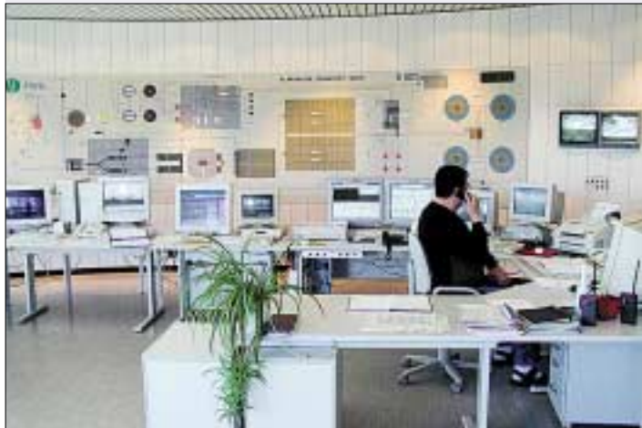
Eberhard Zerull in der modern ausgestattete Leitwarte.
