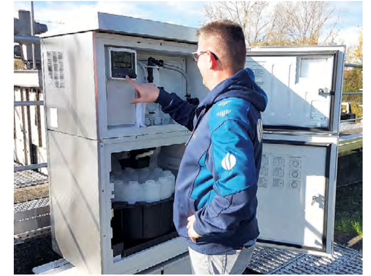
Marko Friedrich (FWA) bereitet die Probenahme am Zulauf der Frankfurter Kläranlage vor. Foto: FWA
