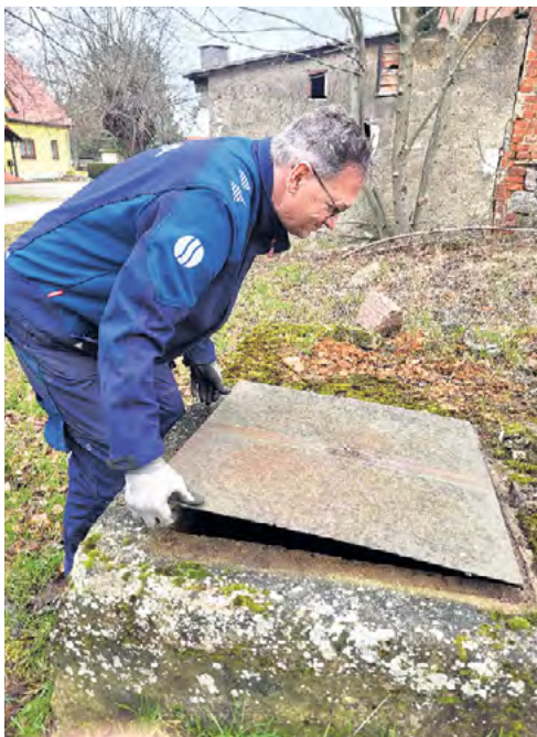
Die Leitung ist derart verrottet, dass sie bei einem Zählerwechsel auseinanderfallen würde.
