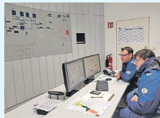
Alle Prozesse der Gewinnung und Aufbereitung des Trinkwassers laufen in der Leitwarte zusammen.
