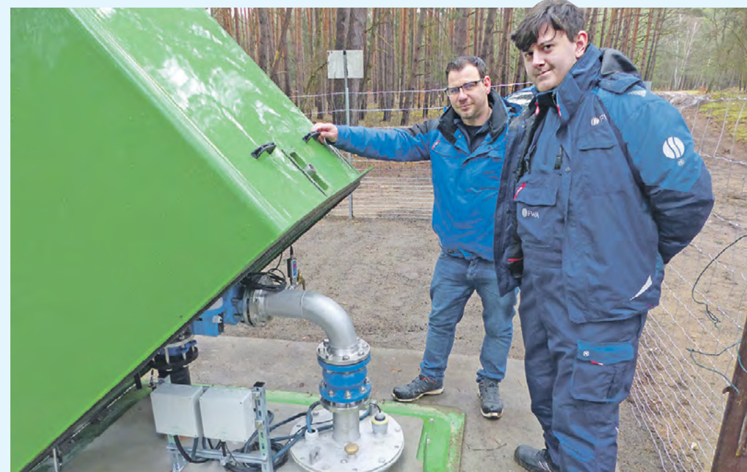
Wasserwerksleiter Sven Kanthak (l.) führt Moritz Hammer über das Gelände. Hier zeigt er einen Brunnen der Spreebogenfassung, der mit einer oberirdischen Brunnenstube, geschützt unter einer Haube, ausgestattet ist.
