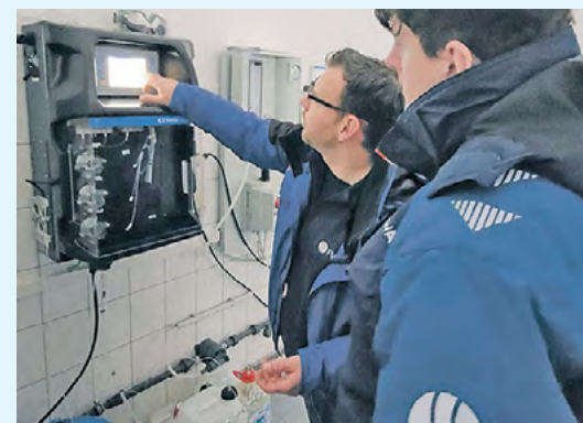
An der Messstrecke im Wasserwerk wird die Qualität des Trinkwassers genau überwacht.
