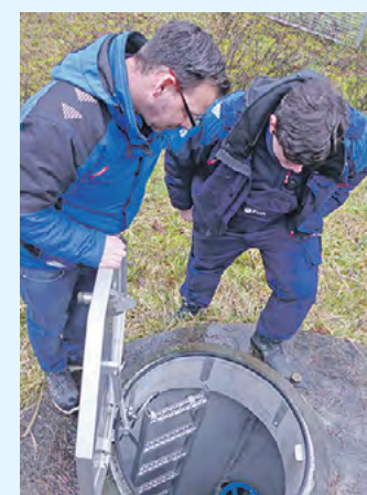
54 Brunnen ziehen das Grundwasser zum Wasserwerk.
