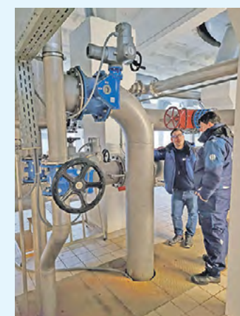
In den Filtern im Wasserwerk wird das Trinkwasser aufbereitet.
