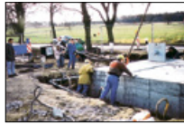
Der Medienring mit dem Abwasserpumpwerk Fürstener Poststraße.
