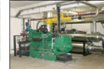
Zur wirtschaftlichen Nutzung des Klärgases wurde das BHKW mit einer Leistung von 300 KW installiert.
