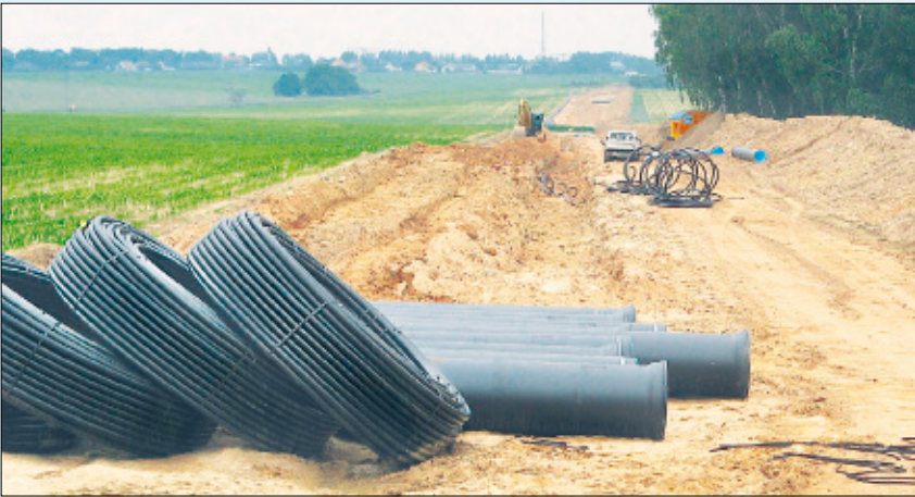
Die Teststrecke für die Sensoren liegt an der Trinkwasserfernleitung zwischen dem Wasserwerk Briesen und dem Hochbehälter Rosengarten. Da bei der Verlegung der Trinkwasserfernleitung im Jahr 2006 auch ein Lichtwellenleiterkabel verlegt wurde, können die Forscher mithilfe dieses Kabels bei ihren Versuchen auf Vergleichsdaten zurückgreifen.
