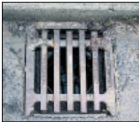
Nur solche Gullis leiten das Regenwasser ab.
