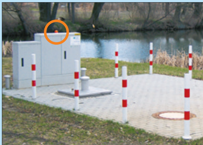
Bei einer Störung im Abwasserpumpwerk blinkt die Leuchte auf dem Schaltschrank.
