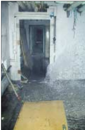
Wasseraustritt im Keller-gang, Sabinusstr. 11/12
