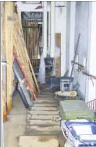
Feuchtigkeit im Leitungs-schacht.
