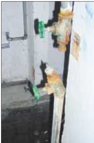
Schaden durch Frosteinwirkung
