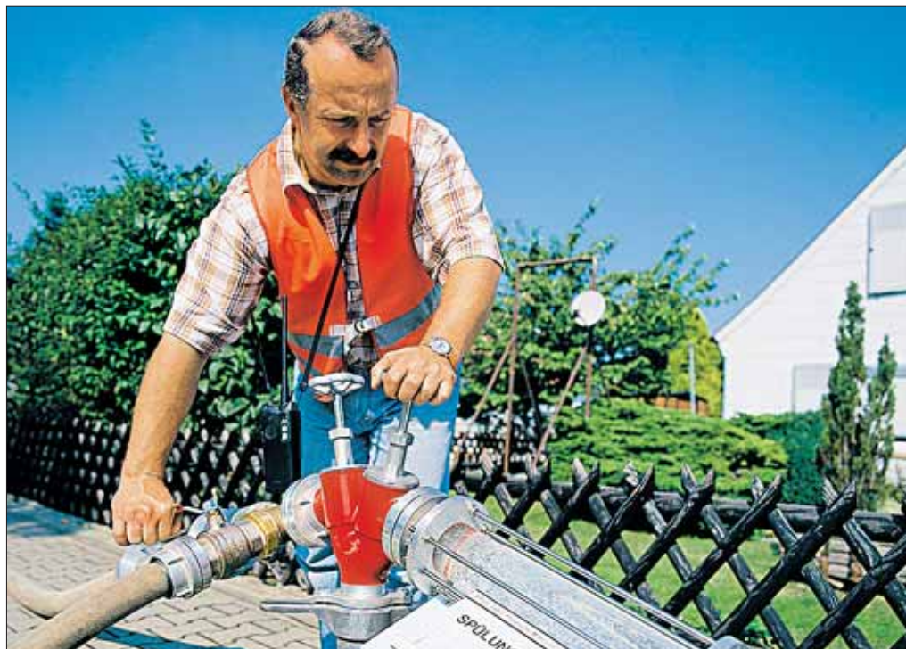
Mit viel Druck strömt komprimierte Luft in das Leitungsnetz.
