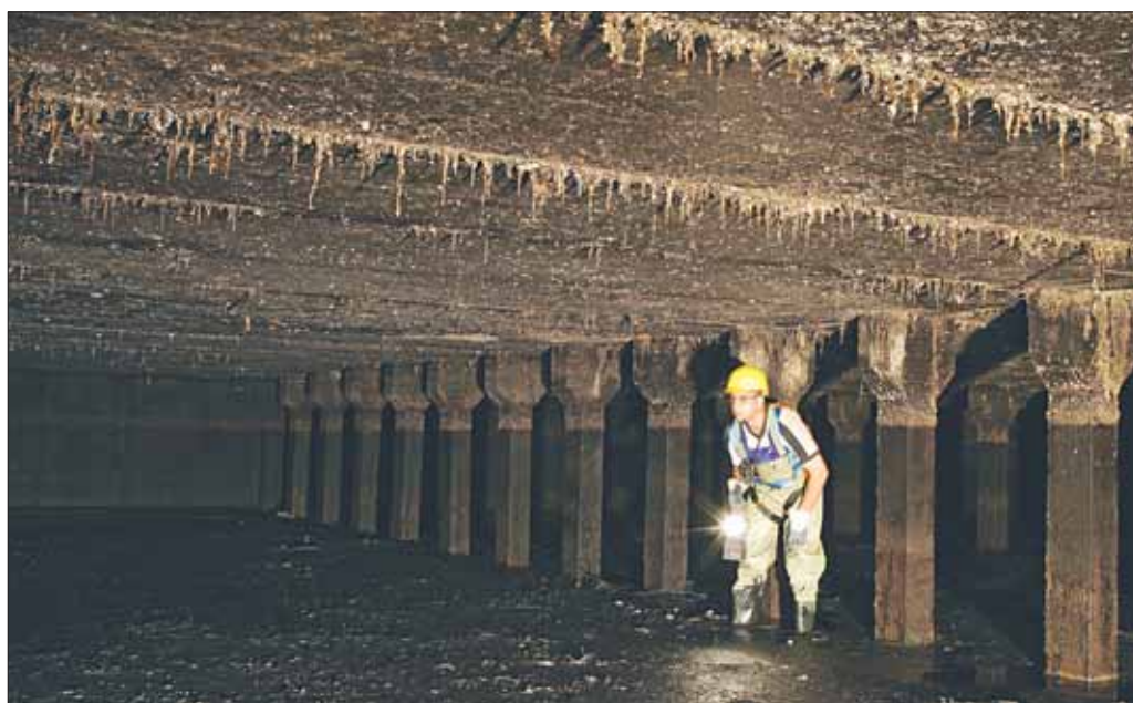
Inspektion des Rückhaltebeckens „Hansa-Nord Schule“. Am Boden sind deutlich Sandablagerungen zu erkennen, die starke Niederschläge mit sich führen.
