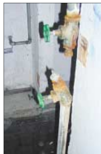
Schaden durch Frosteinwirkung
