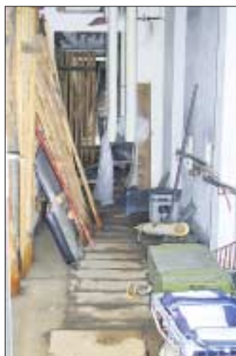
Feuchtigkeit im Leitungsschacht.
