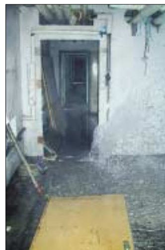
Wasseraustritt im Keller-gang, Sabinusstr. 11/12
